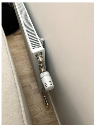
Vattenburna radiatorer på övervåning.
