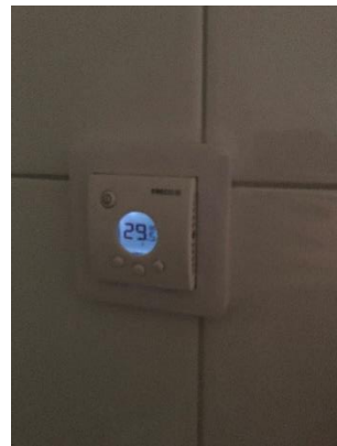
Reglerenhet golvvärme på el i badrummet på övervåning.
