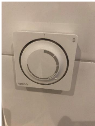
Reglerenhet golvvärme i badrummet entrévåning.
